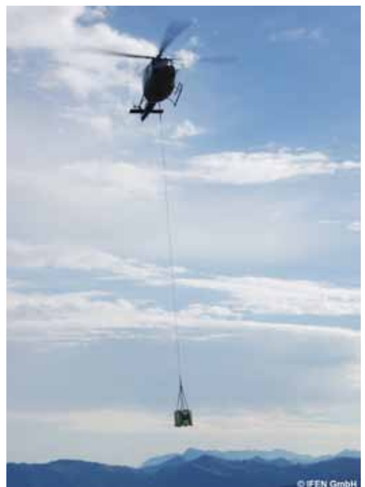
Im September 2010 wurde eine »GATE-Sendestation GTS7« am Rauhenkopf installiert. © IFEN GmbH
